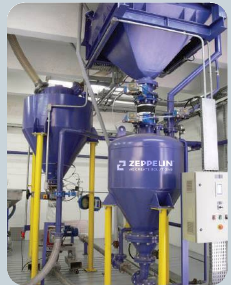
Centro de Testes Test Center Centro Tecnológico
