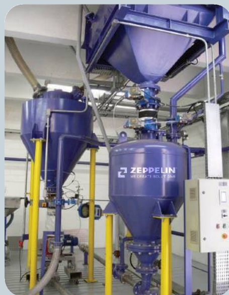
Centro de Testes Test Center Centro Tecnológico
