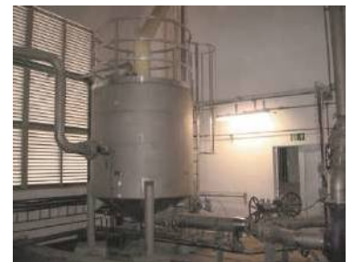
Tanque de mistura / Mixing tank / Tanque de Mesclado
