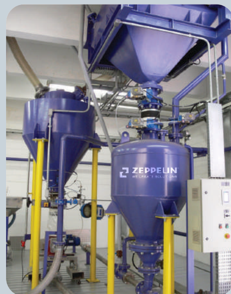
Centro de Testes Test Center Centro Tecnológico
