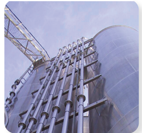
Silos e transporte pneumático Silos and pneumatic conveying Silos y transporte neumático
