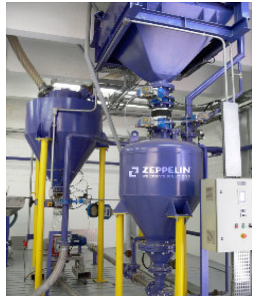
Centro de testes / Test Center Centro tecnológico
